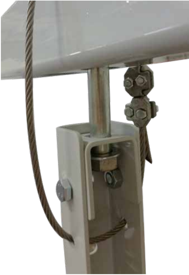
Bilde 7: Sikkerhetswire montert rundt opphenget og traversen i hjørnet av opphenget.
