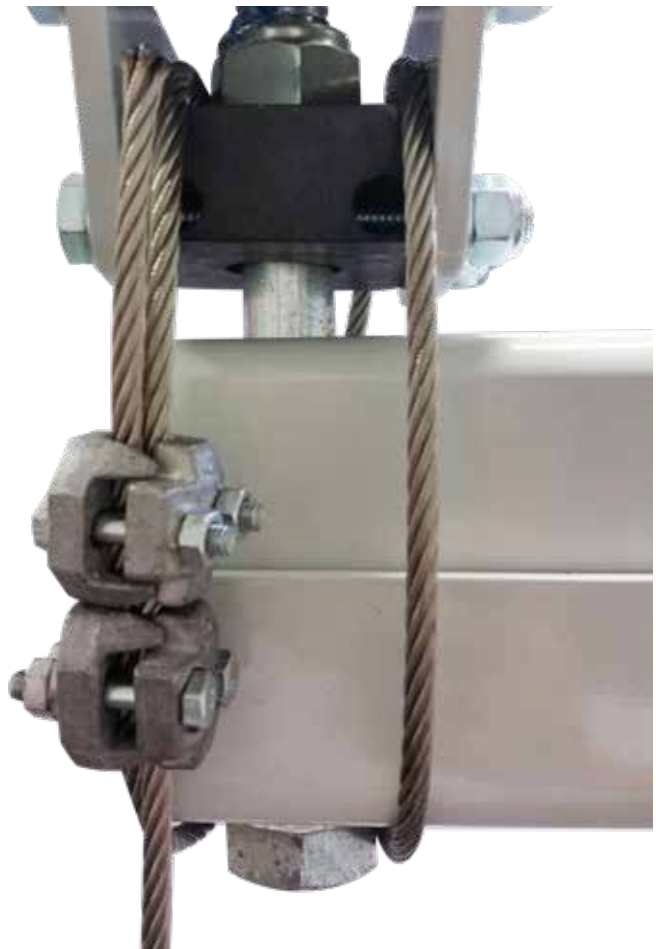
Bilde 6: Bakside av travers med sikkerhetswire montert rundt løpekatt og travers.
