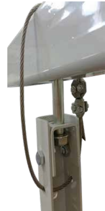
Figur 47: Sikkerhetswire montert på oppheng med travers.
