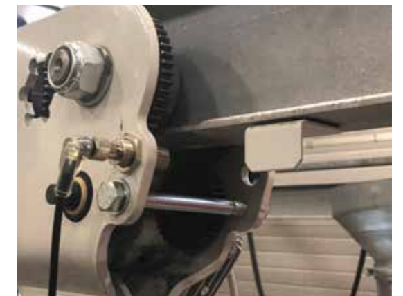
Figur 7: Løpekatt med sensor og markør.
