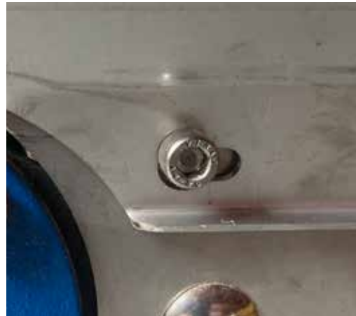
Figur 16 Tetningslist løsnet og skjøvet til siden.
