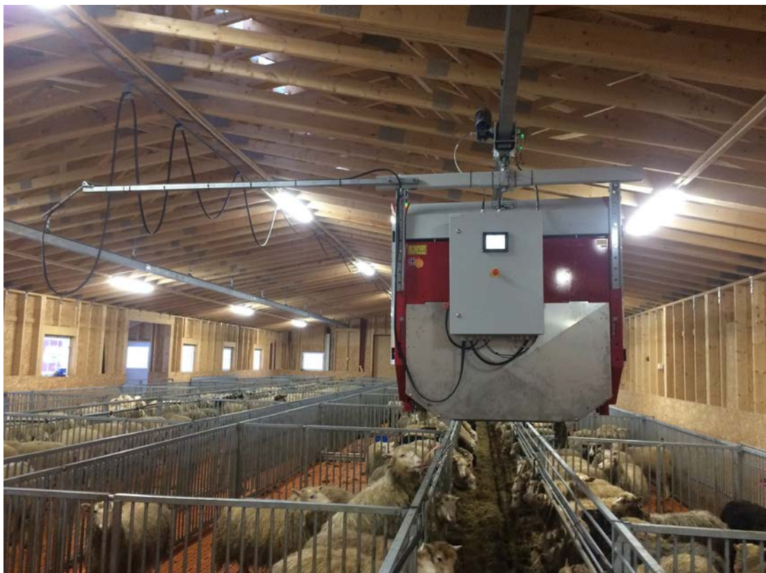
Figur 3 OneTouch Feeder i én skinne opphengt med travers. Strømløsning her er kabelskinne.
